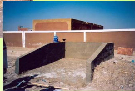
Transit pour entreposer les déchets
